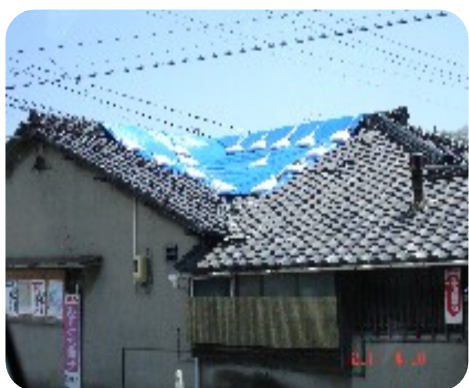
地震で屋根が破損したいわき市内の住宅
