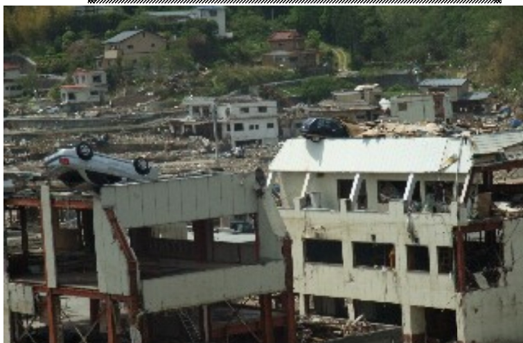
巨大津波によって破壊されたコンクリートの建物の3階屋上に流されてきた乗用車が引っかかっている。
